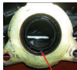
Joint de tube-guide endommagé
